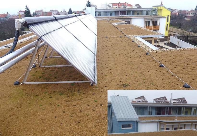
OZE - solární teplovodní systém
